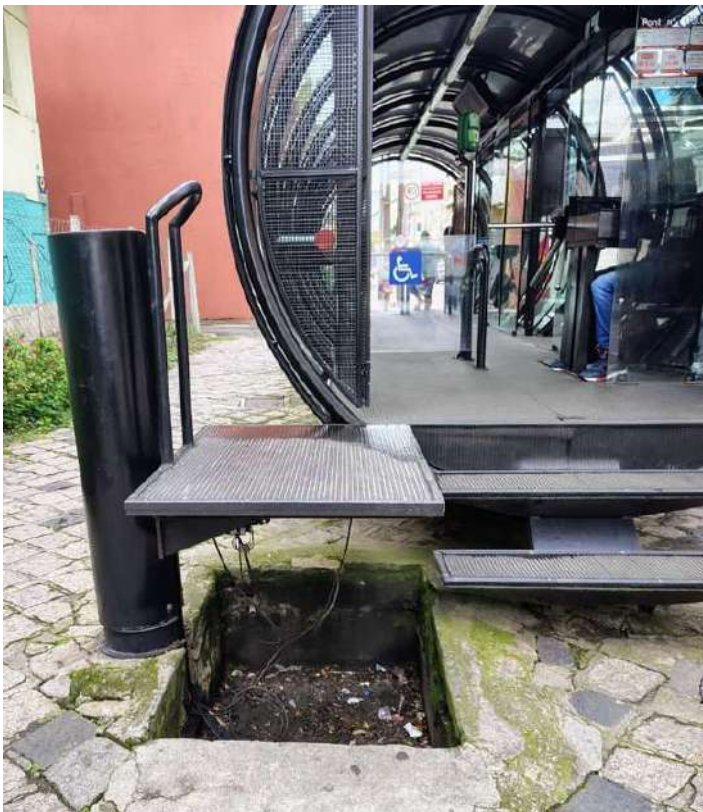
Figura 31- Imagem Elevador em cima
