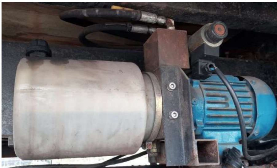
Figura 6 – Imagem sistema Óleo-Hidráulico Elevador GI
