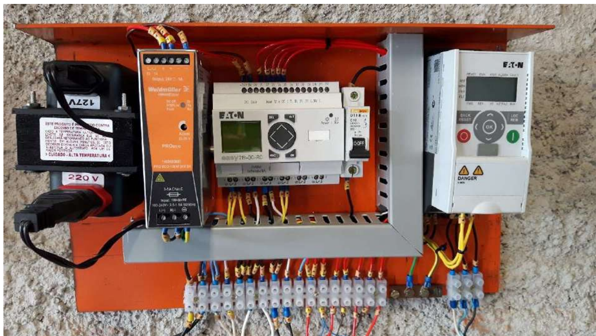
Figura 10 – Imagem Painei Elétrico Elevador GI com CLP EASY da Eaton/Moller
