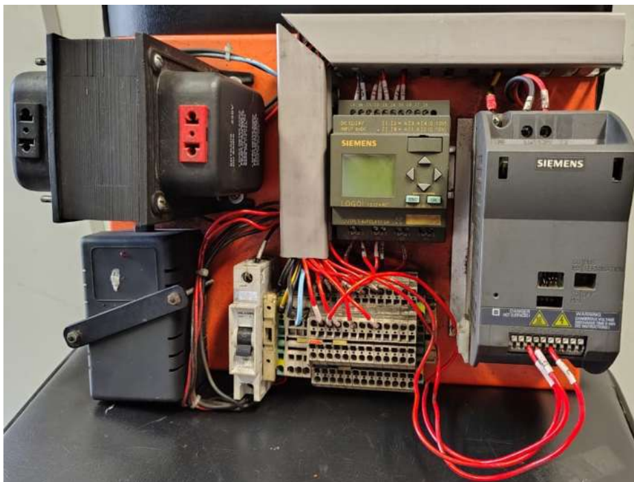
Figura 8 – Imagem Paineleletrico Elevador GI com CLP LOGO da Siemens
