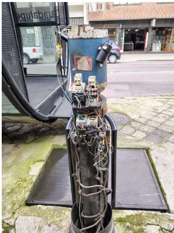
Figura 34 – Imagem Comando elétrico elevador de coluna
